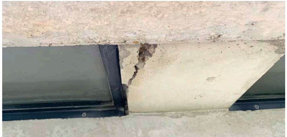
(6) Betonschäden: Abplatzung von Beton
